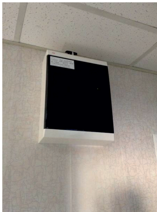
Щит автоматики на базе блока SE 6i50
